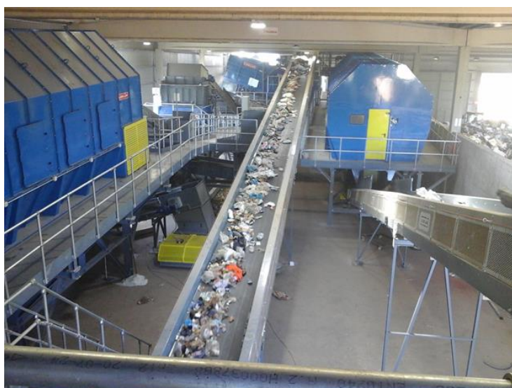
Mejoras en la línea de separación de residuos del Ecoarque de Mérida
